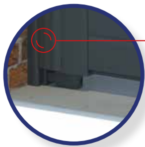
Joint cache-vue excentré
