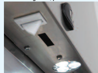
Coupure automatique de la ventilation
